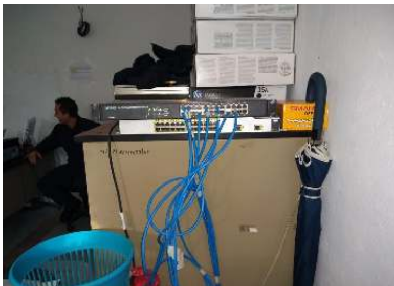
Instalación de Red y configuración de Switch en la oficina de Plataforma Mexico, Dir. de Seguridad Publica Mpal.
